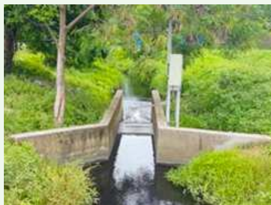
Medidor de caudal
